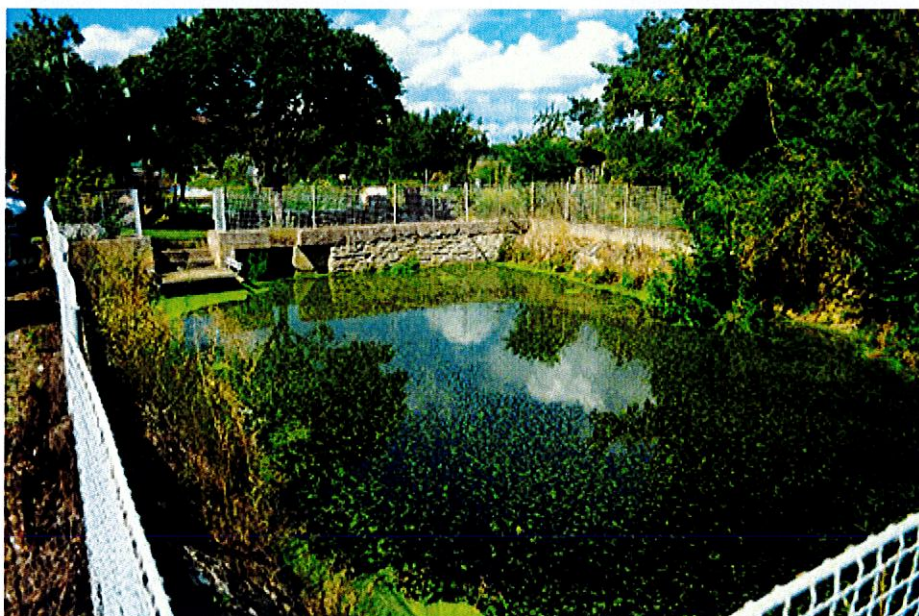
Nádržka v ulici směrem na Vršovku je v havarijním stavu.
